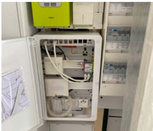
Figure 1 : Exemple de tableau de communication dans le neuf
