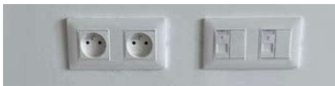
Figure 2 : Exemple prises RJ45 juxtaposées avec prises 2P+T dans la pièce principale du logement
